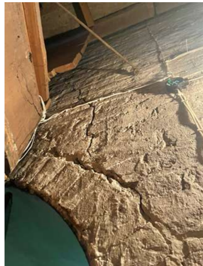
Изобр. 13. Критические дефекты (сквозные трещины) в конструкциях несущих стен и уникальных росписях 1724 г. Фото автора
