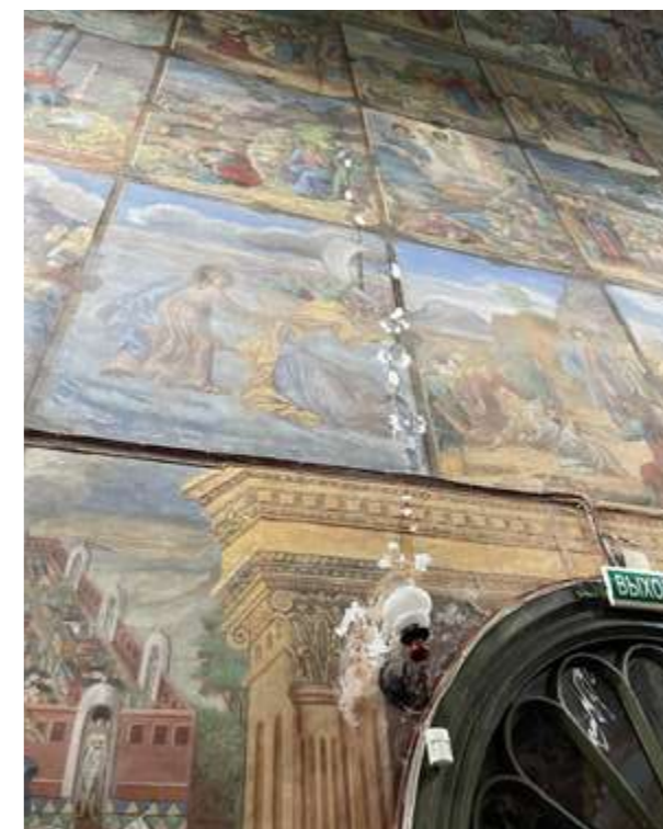
Изобр. 14. Критические дефекты (сквозные трещины) в несущих конструкциях стен и уникальных росписях 1724 г. Фото автора
