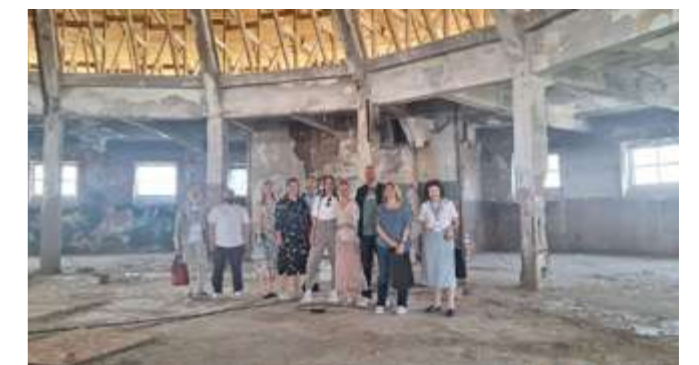
Изобр. 2. Посещение экспертами объекта культурного наследия «Общественная баня» в г. Тюмень. 2024 г.
