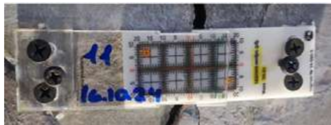
Изобр. 11. Мониторинг состояния несущих конструкций стен с помощью маяков «ЗИ-2», фиксирующих величину раскрытия трещин 7
