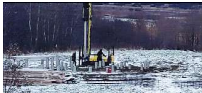
Изобр. 9. Устройство забивного свайного поля в защитной 200-метровой зоне ОКН под туристический объект «Гостиница с баней и открытым бассейном» 7
